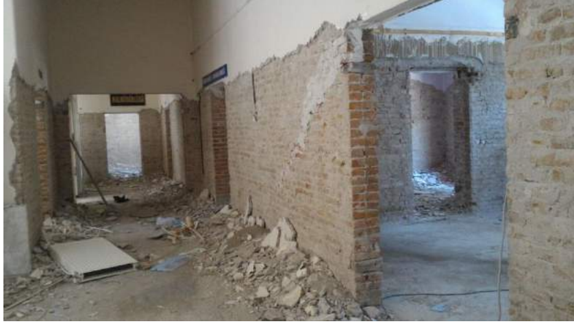
Şekil 10: Yapı İç Duvarlarında Oluşan Çatlak
