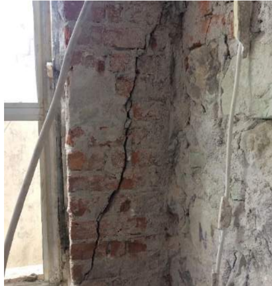
Şekil 9: Yapı Dış Duvarlarında Oluşan Çatlak
